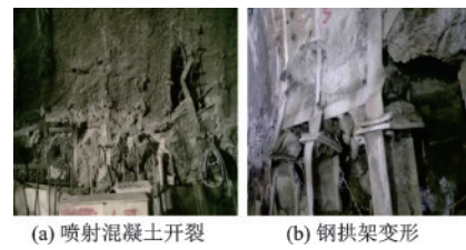
图9 内层初期支护变形开裂
